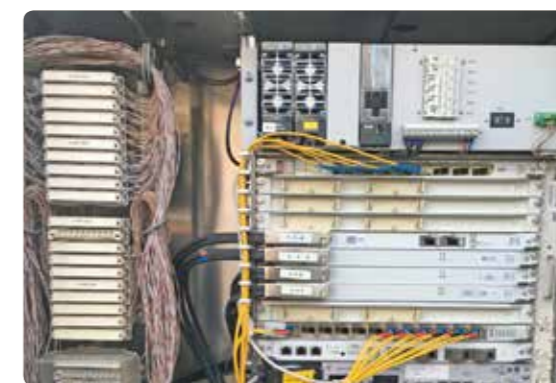
Das Bild zeigt das Innere eines sogenannten Multifunktionsgehäuses, welches im Bereich der Stadt aufgebaut ist
